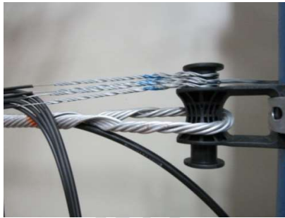
Ancoragem de cabo e drop óptico
