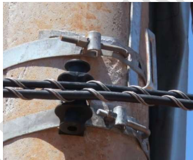
Sustentação de dois cabos ópticos
